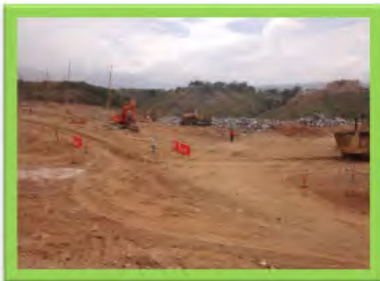
SEÑALIZACIÓN EN EL SITIO DE DISPOSICIÓN FINAL
